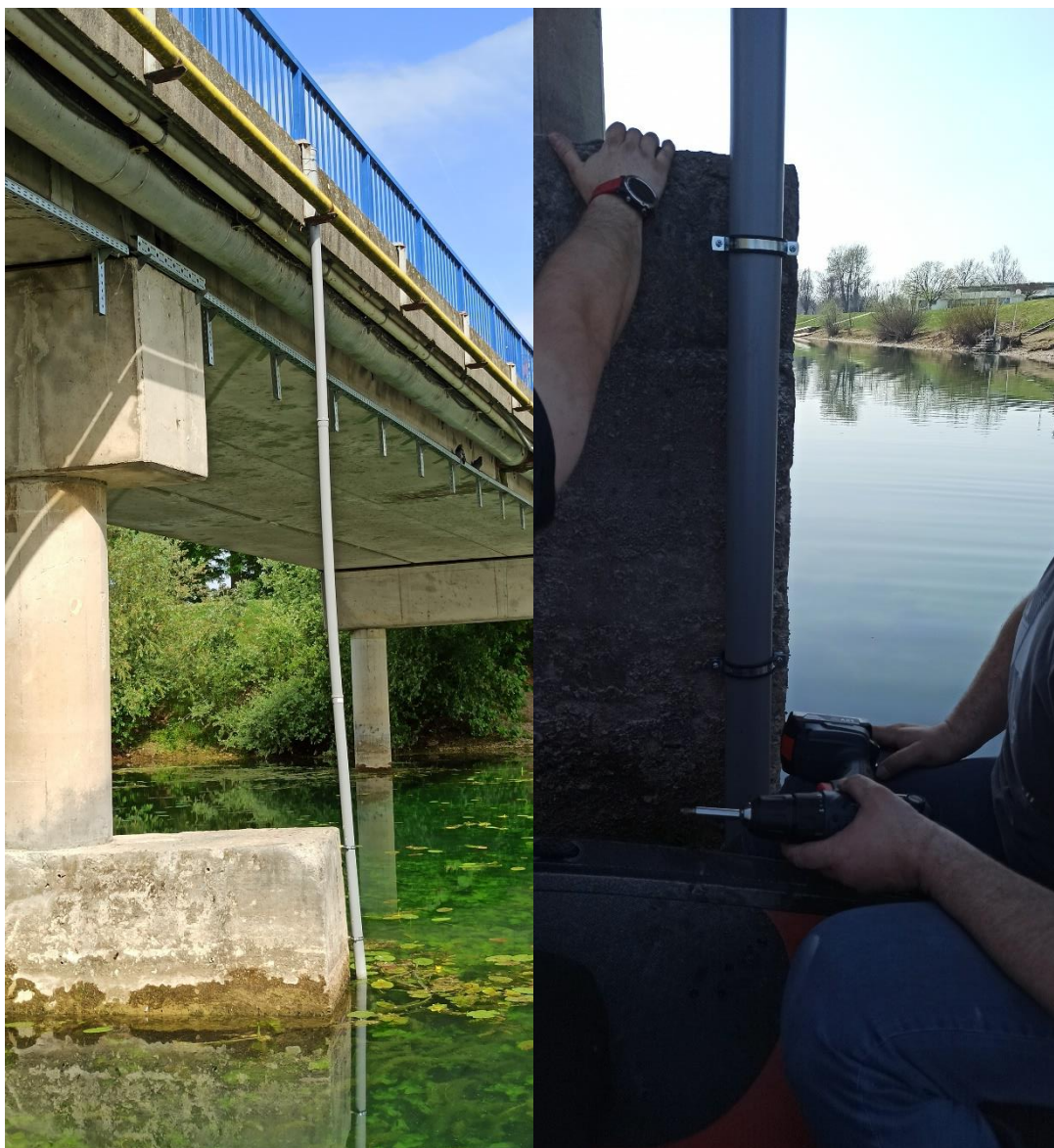
Slika 3.3 Plastična cijev učvršćena na tri mjesta za konstrukciju mosta na Jarunu. X=5071901,01 ; Y=454279,26
