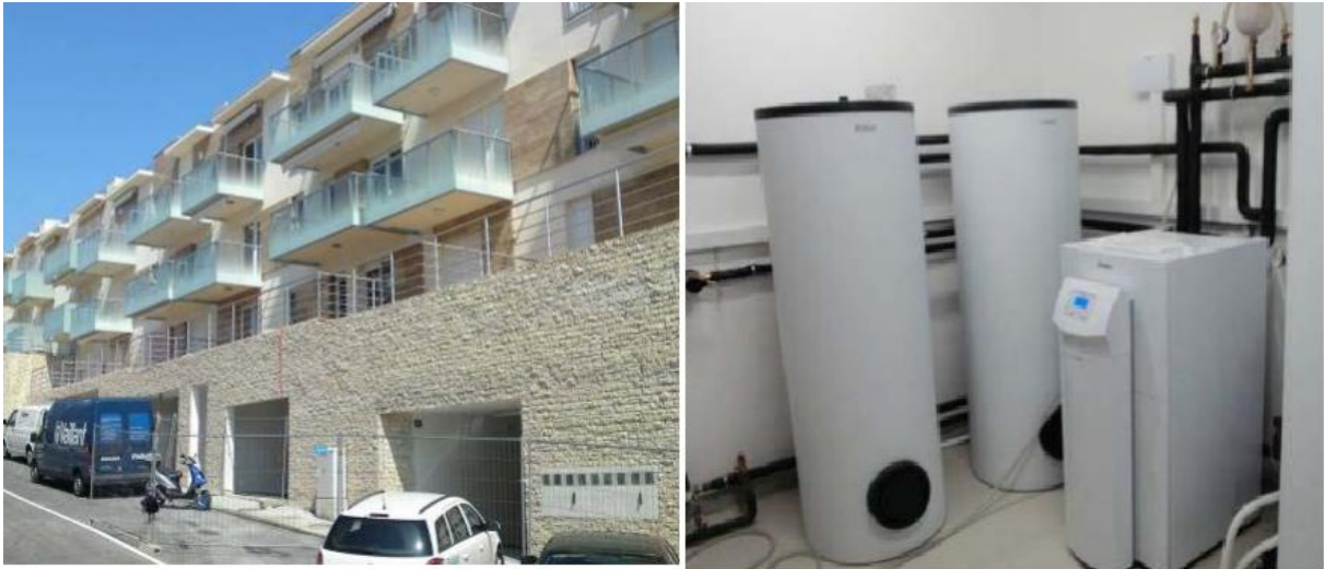
Slika 3-8. Sustav dizalice topline ugrađen u stambenu zgradu u Splitu (Seadrion Project, 2018a).
