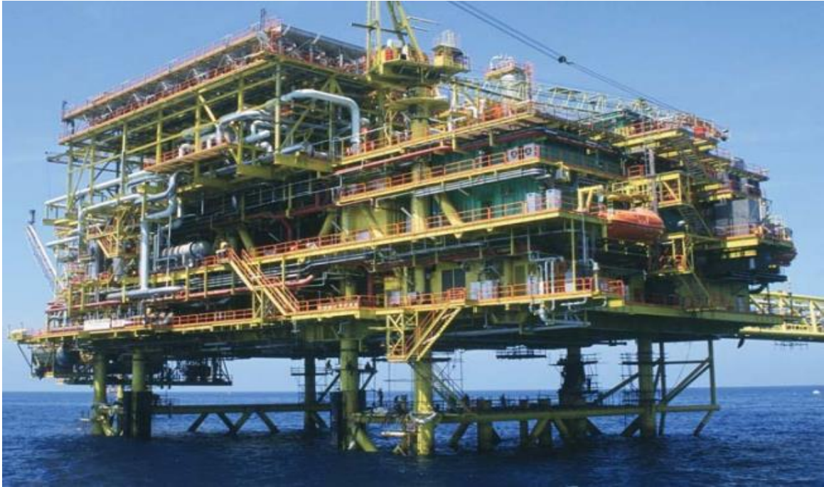
Slika 4-1. Separex membransko postrojenje instalirano na odobalnoj platformi (Honeywell UOP, 2011a)
