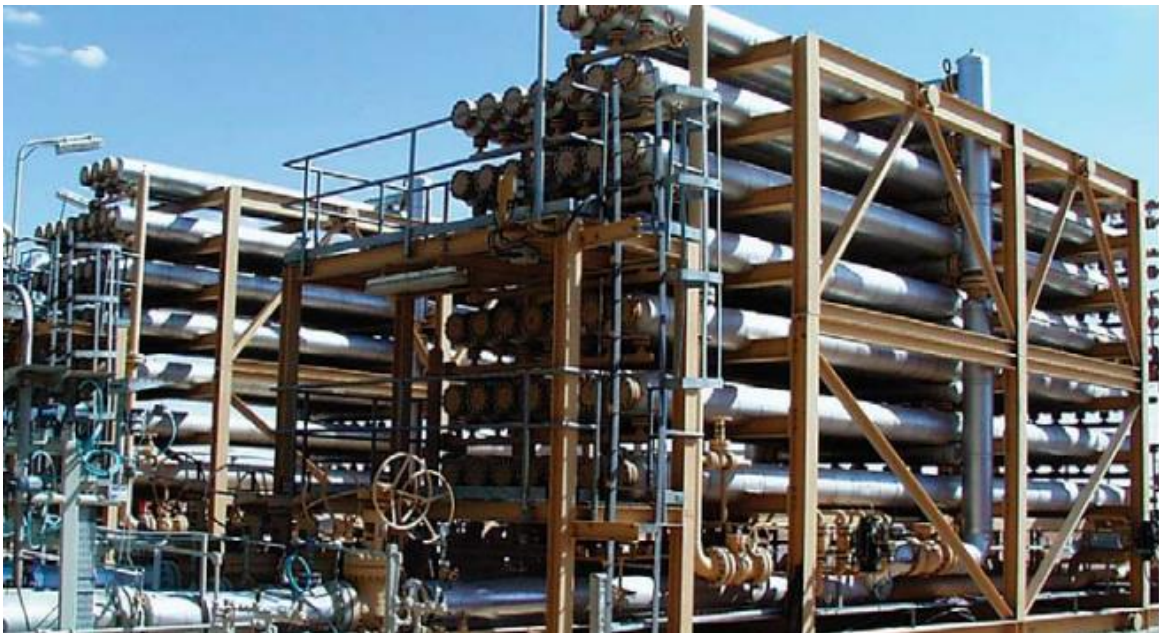
Slika 4-2. Separex membransko postrojenje instalirano u Egiptu (Honeywell UOP, 2011b)
