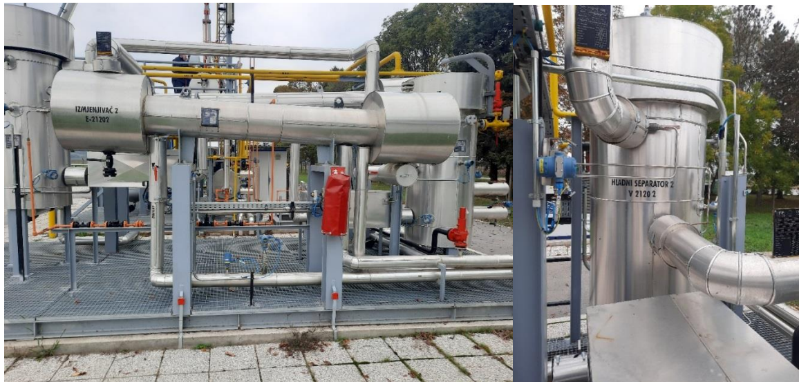
Slika 4-10. Hladnjak tj. izmjenjivač topline propan/plin (lijevo) i nisko temperaturni separator II (desno)
