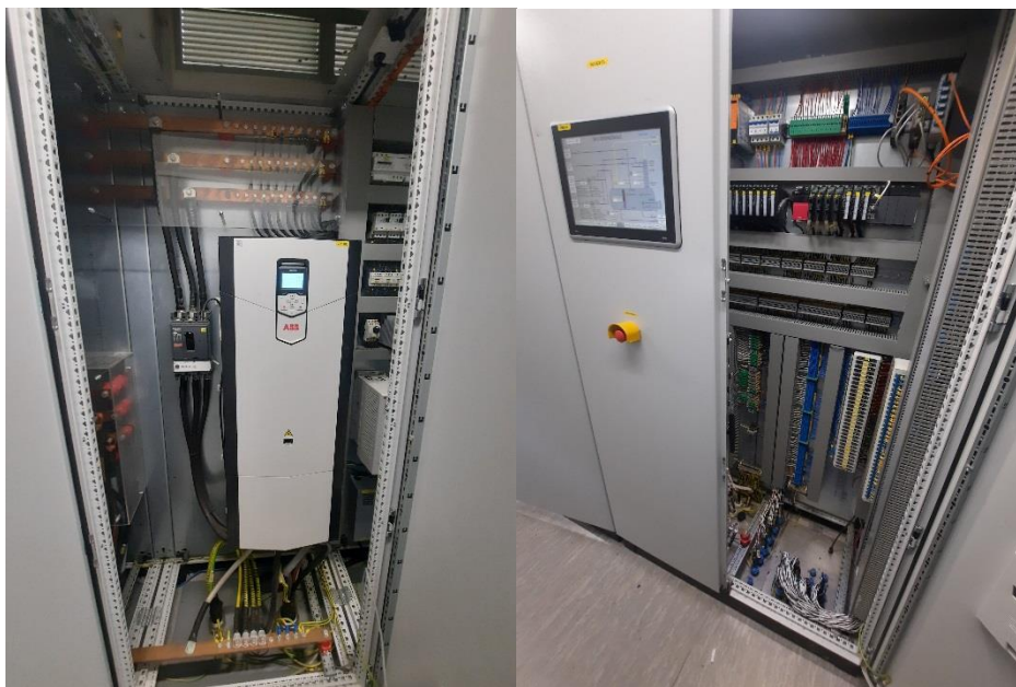
Slika 4-5. Frekvencijski pretvarač (lijevo); Sklop automatizacije i upravljanja postrojenjem (desno)
