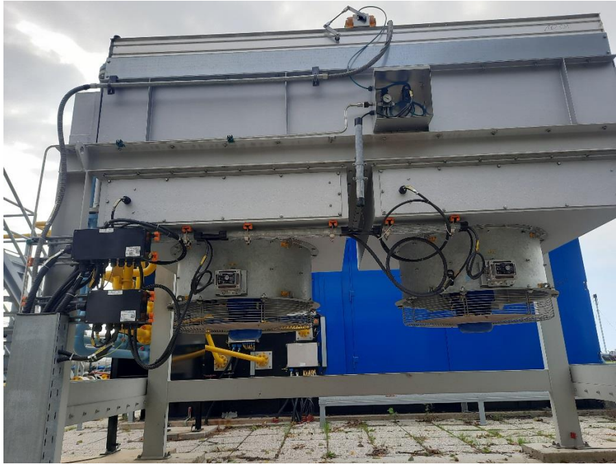
Slika 4-3. Zračni hladnjak kompresora
