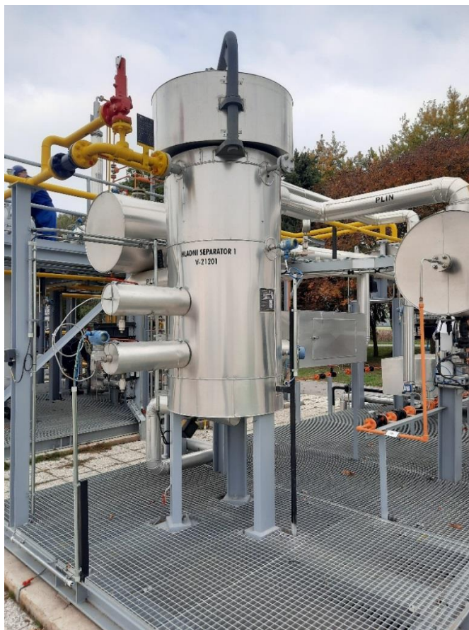
Slika 4-9. Nisko temperaturni separator I
