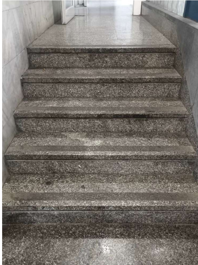
Slika 5-14 Granitne stepenice u zgradi na Trgu bana Josipa Jelačića u Zagrebu (foto: V. Apostolovski)
