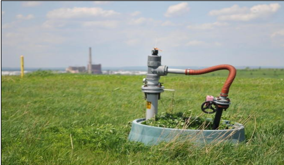
Slika 3-9. Bušotinska glava plinske bušotine na vrhu odlagališta komunalnog otpada (Nabavi, 2020)
