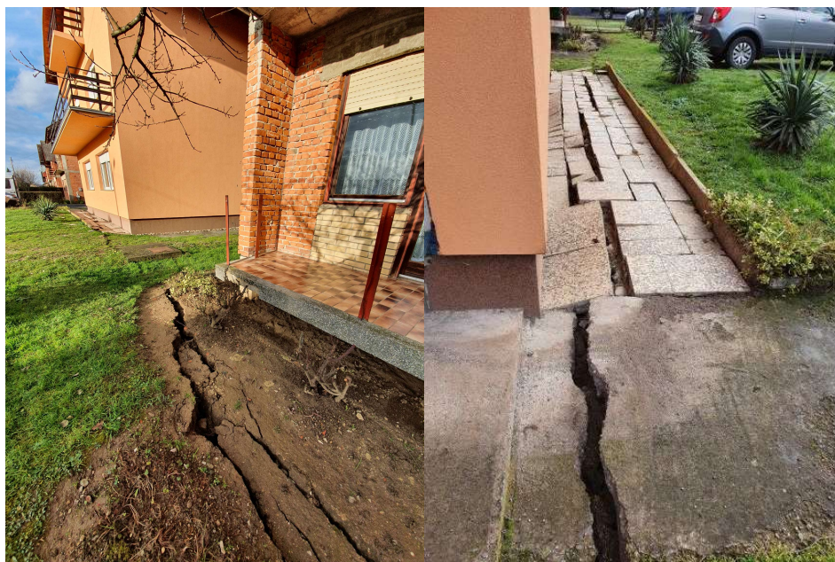
Slika 3-4. Pukotine u blizini objekata (Arhiva: Taus d.o.o., 2021)
