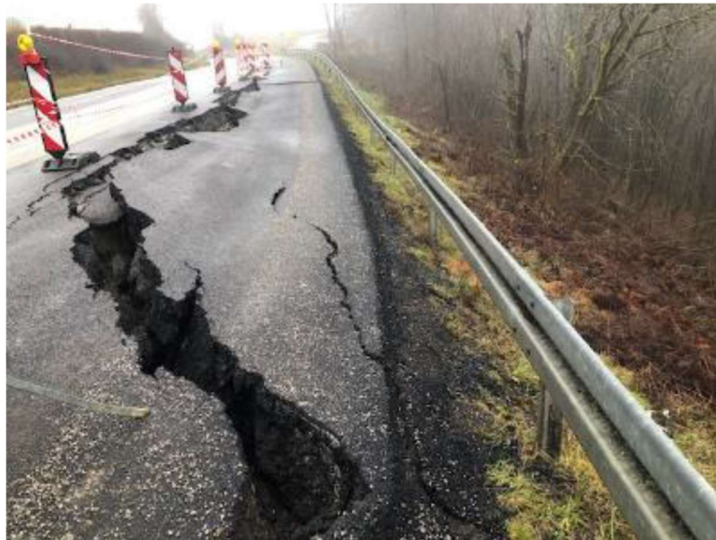
Slika 3-5. Oštećenje ceste prilikom klizanja tla uzrokovanog potresom (Tomac i dr., 2021)
