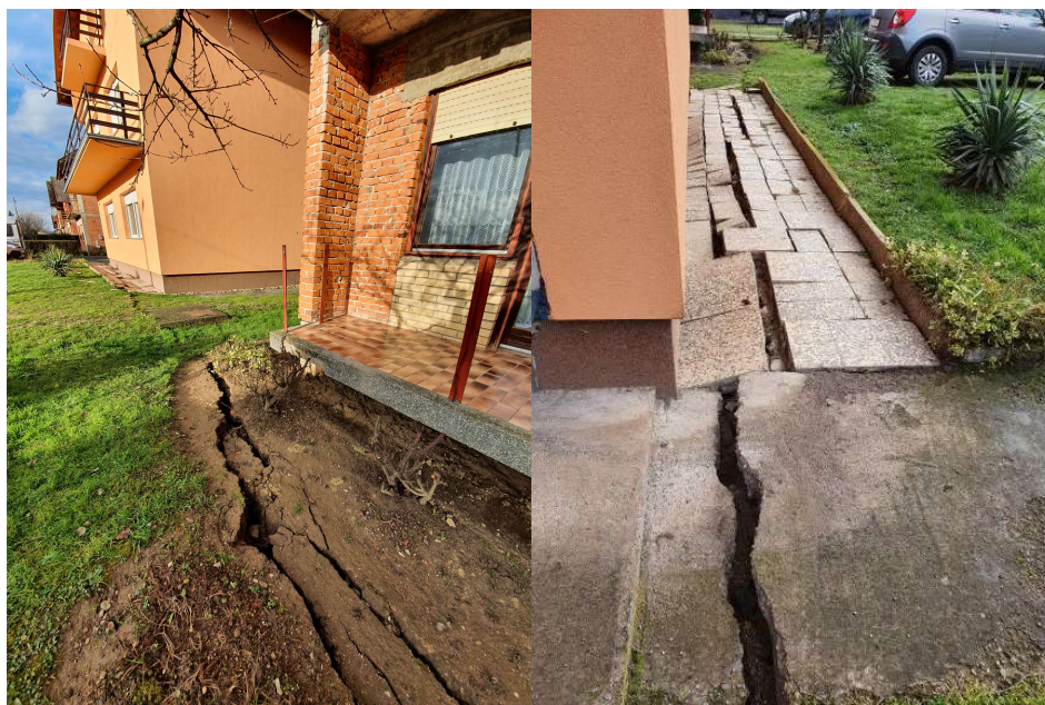
Slika 3-4. Pukotine u blizini objekata (Arhiva: Taus d.o.o., 2021)
