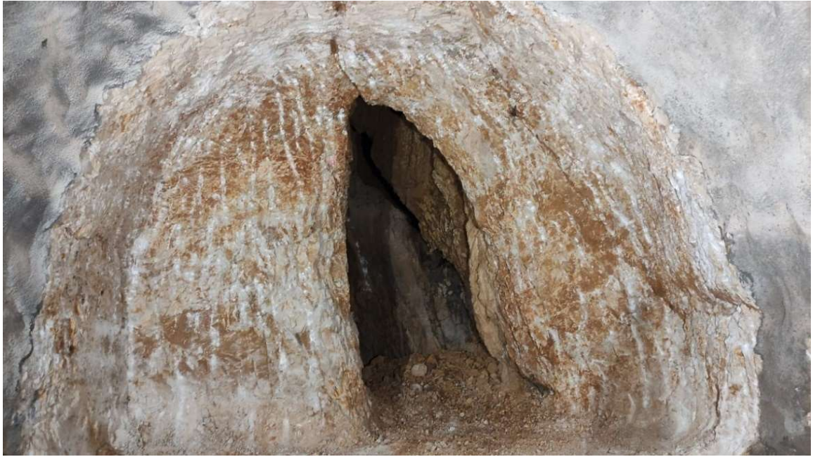
Slika 7-17. Kaverna u rudistnom vapnencu gornje krede na stacionaži 31+077,00
