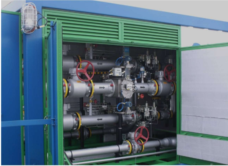
Slika 6-2 Mjerno redukcijnska stanica (Plinacro, 2020)
