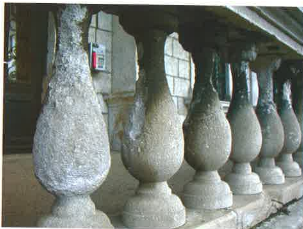
Sl. 8: Vila Eliza (Ekonomski fakultet u Dubrovniku). Oštećene, betonom obnovljene, te ponovno oštećene kolonade. U donjem dijelu vidljiv je potpuno neoštećeni kamen (2007.g.)
