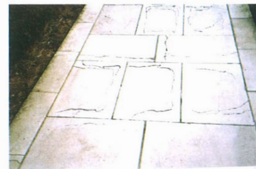
Oštećenja na kamenom postolju
