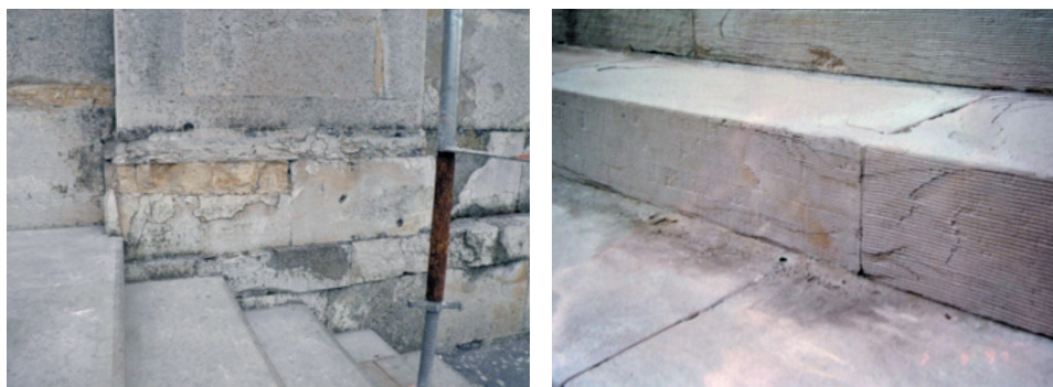
Slika 2. i 3. Oštećenja uslijed cementa
