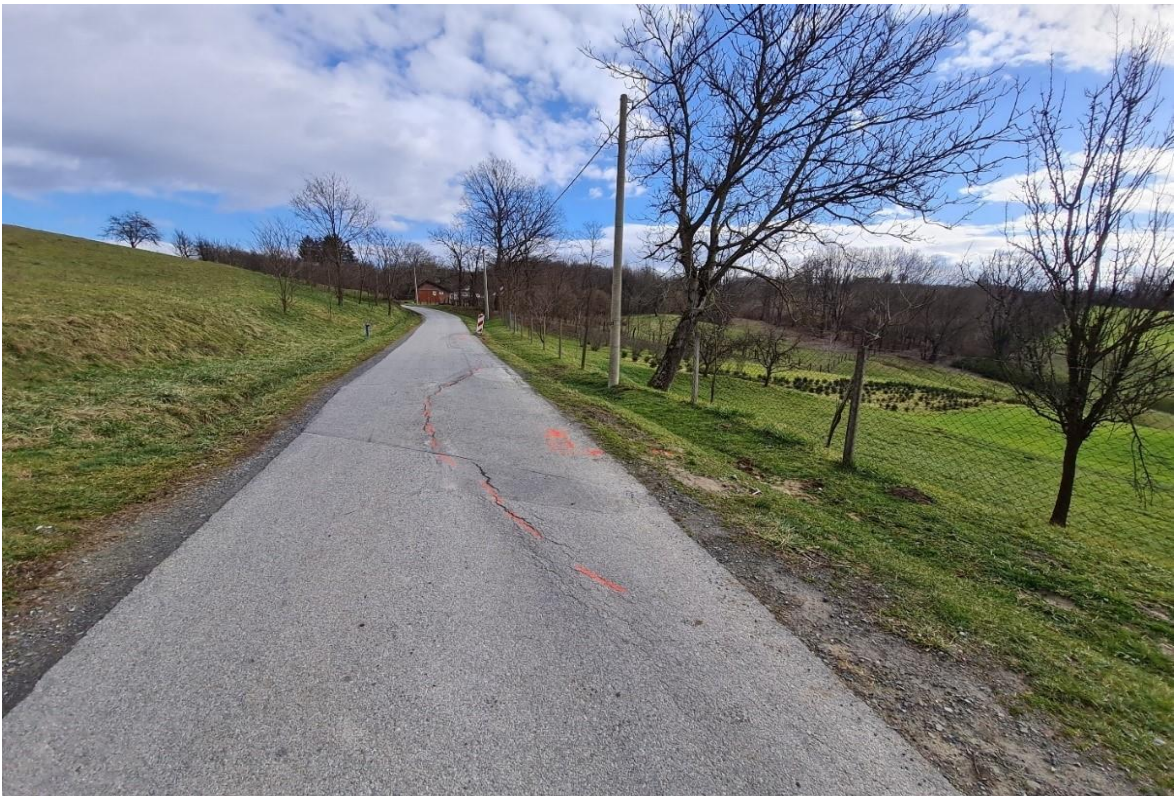
Slika 4-3. Usijedanje prometnice na lokaciji 2 ŽC4043, oko stacionaže 0+727
