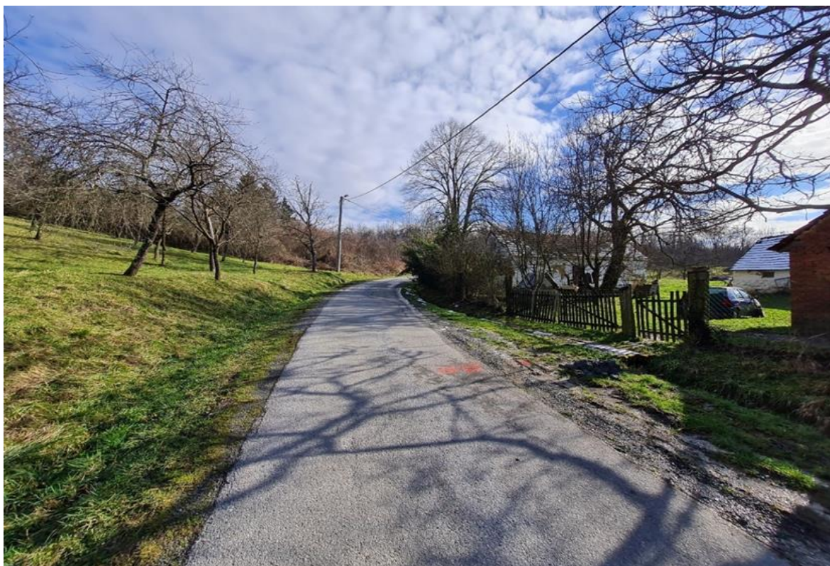
Slika 4-4. Usijedanje prometnice na lokaciji 3, oko stacionaže 1+050
