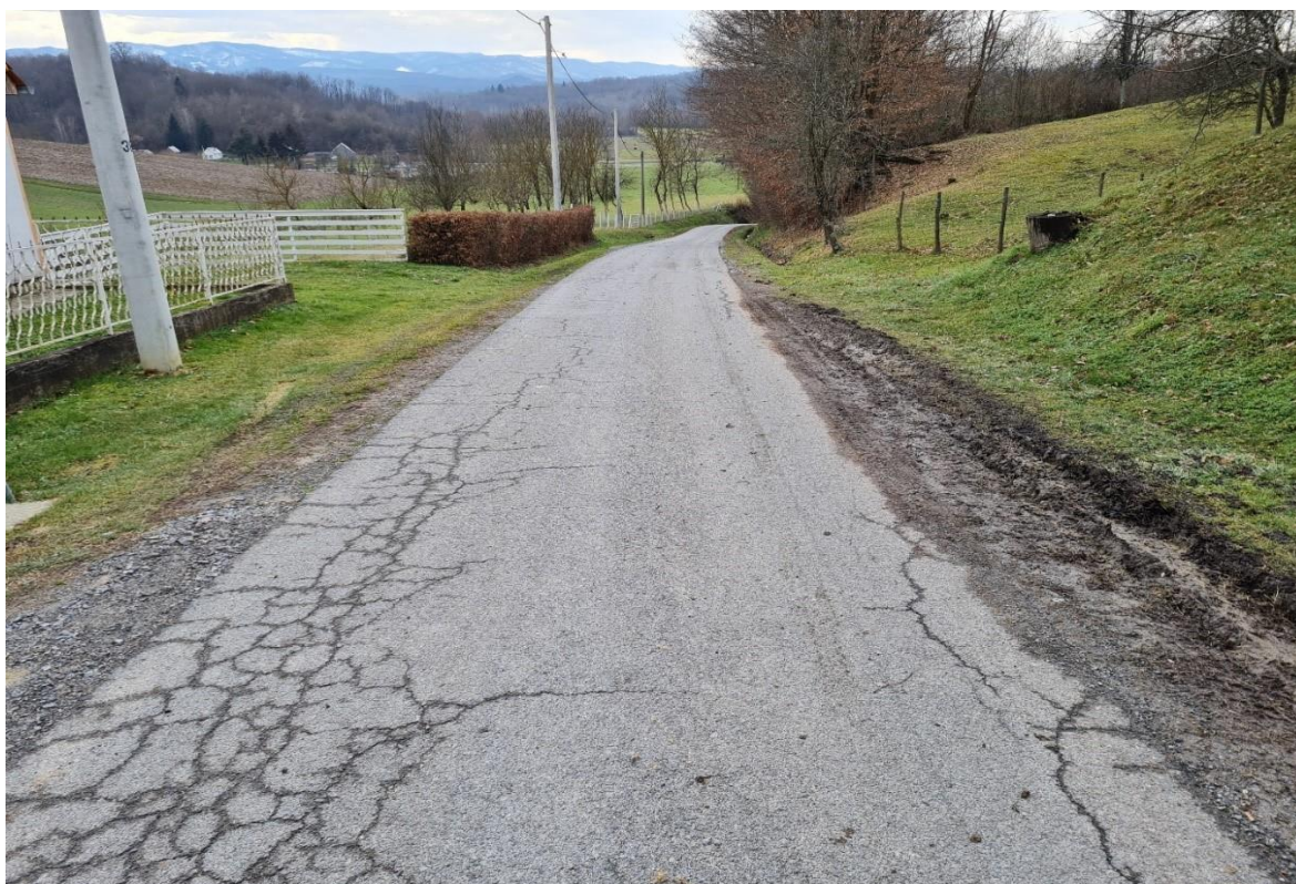
Slika 4-2. Lokacija 1 oko 0+500 na županijskoj cesti ŽC 4043
