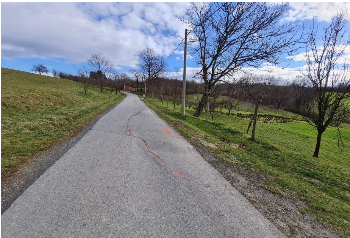
Slika 4-3. Usijedanje prometnice na lokaciji 2 ŽC4043, oko stacionaže 0+727
