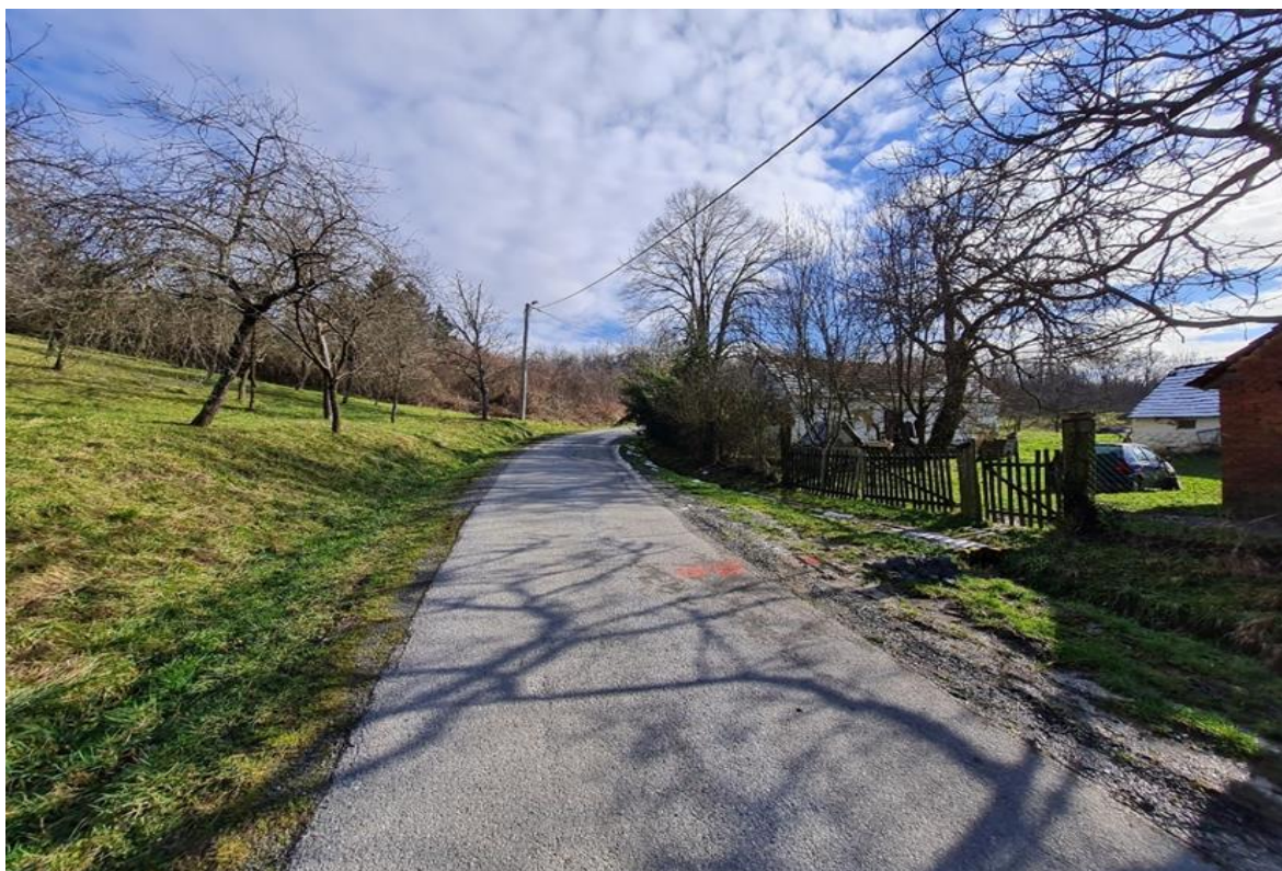
Slika 4-4. Usijedanje prometnice na lokaciji 3, oko stacionaže 1+050
