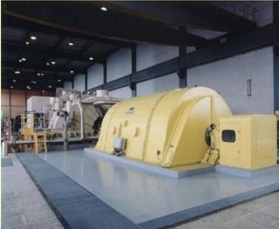
Slika 4-4. Blok K: parno-turbinski agregat (Jukić i Majcen, 2011)
