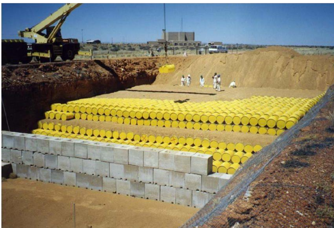
Slika 2-1. Pripovršinsko odlagalište RAO (Koeberg Alert Alliance, 2016).
