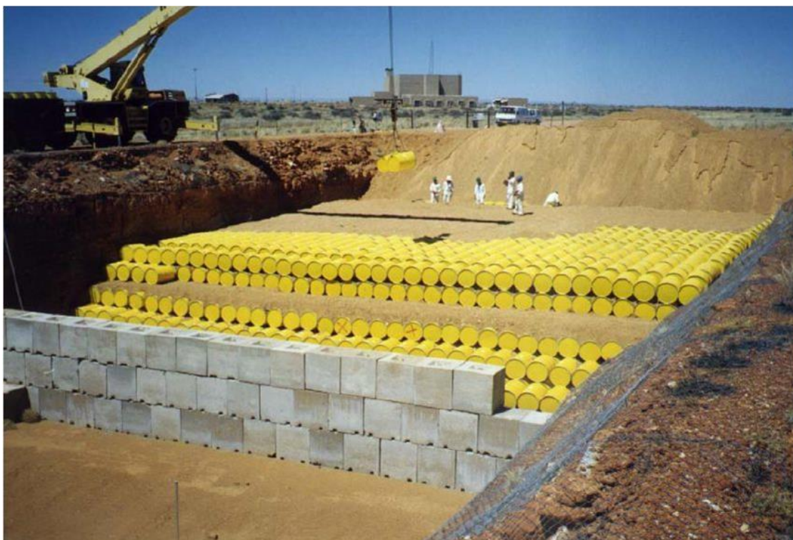
Slika 2-1. Pripovršinsko odlagalište RAO (Koeberg Alert Alliance, 2016).
