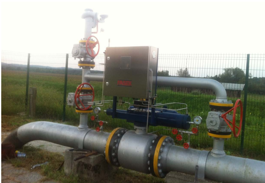
Slika 8-3. Blokadno-ispuhivačka stanica Čazma
