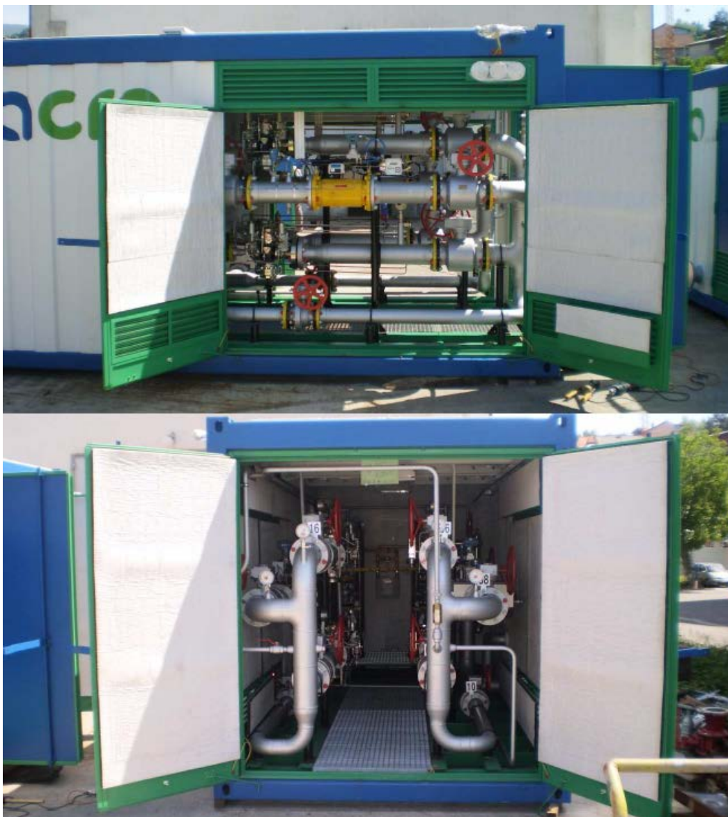
Slika 4-1. Mjerno-redukcijska stanica (www.plinacro.hr, 2016)
