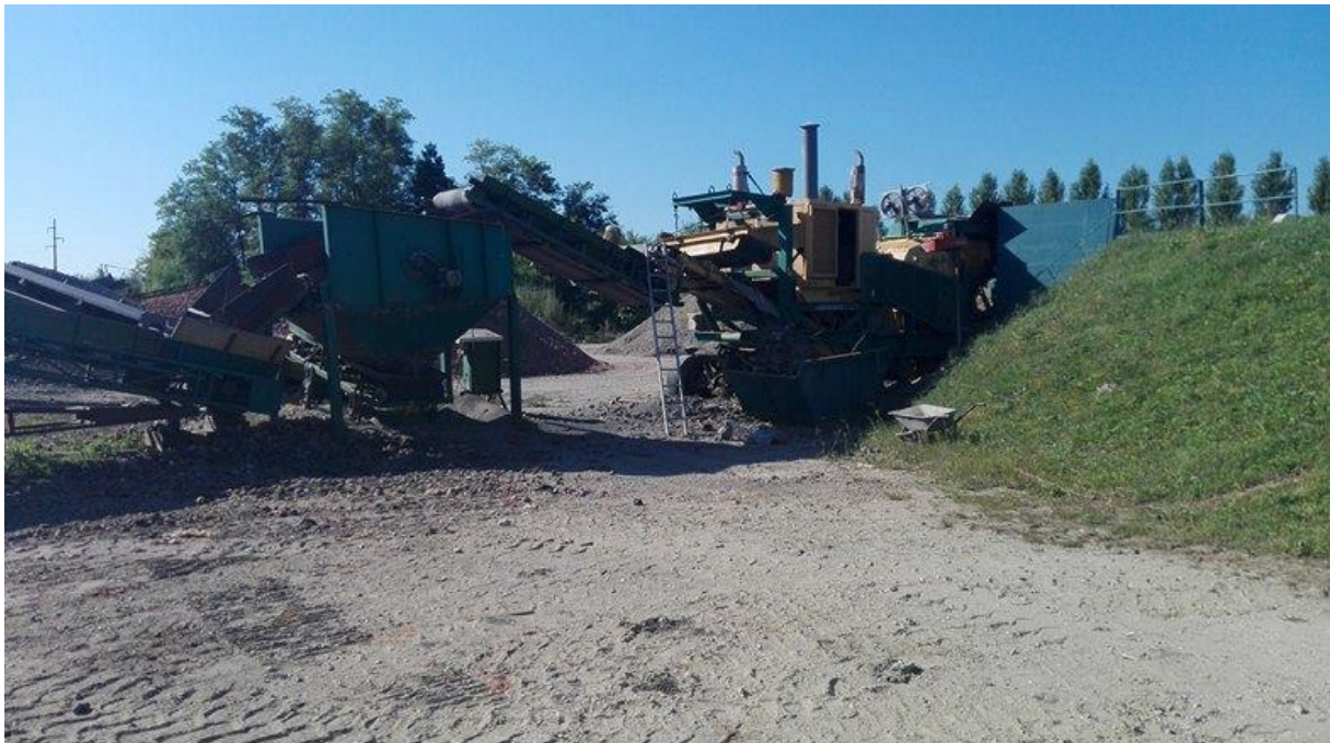
Slika 4-8. Pokretno postrojenje za drobljenje i vibracijsko sito „Powerscreen commander“
