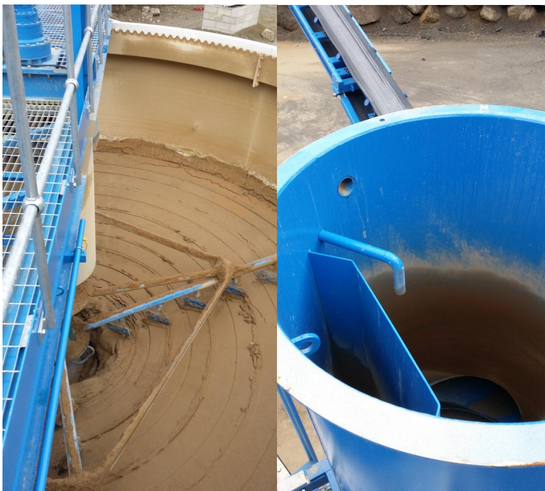
Slika 3-9. Unutrašnjost sedimentacijskog bazena i posuda za miješanje otpadne tehnološke vode i flokulanta
