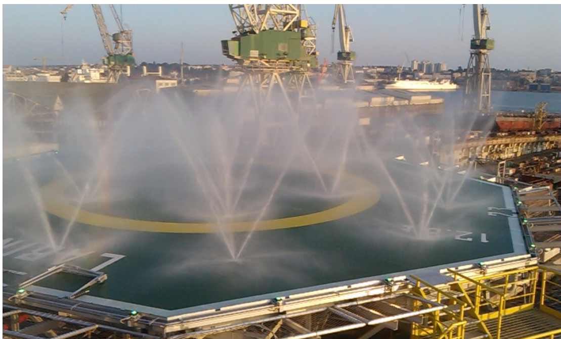
Slika 5-6. Novi sustav zaštite od požara na helikopterskoj palubi (Crosco, 2015c)
