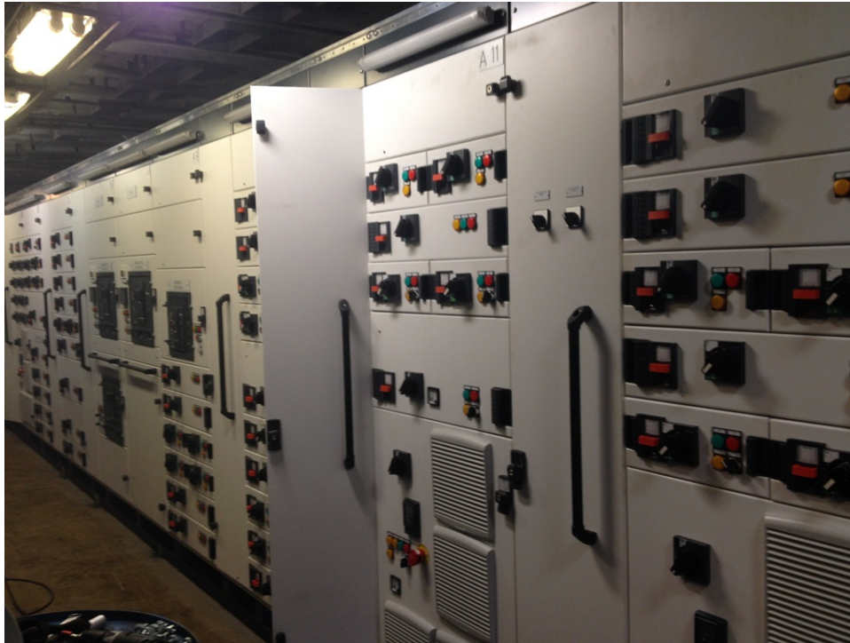
Slika 5-8. Novi glavni sklopni blok nakon ugradnje (Crosco, 2015c)
