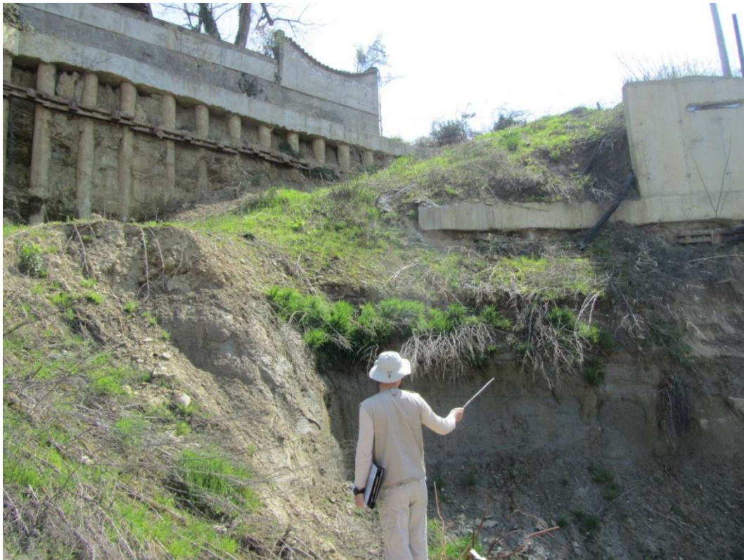
Slika 85 Napušteno gradilište u Kvaternikovoj ulici koje je prouzročilo reaktiviranje klizišta broj 640209 identificiranog prema stereomodelu iz 1964. godine (snimljeno 2013. godine)
