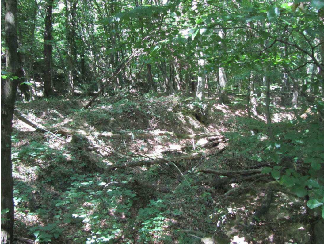
Slika 78 Aktivno klizište broj 640722 i 980657 na donjem dijelu padine uz potok Jelenovac (snimljeno 2013. godine)
