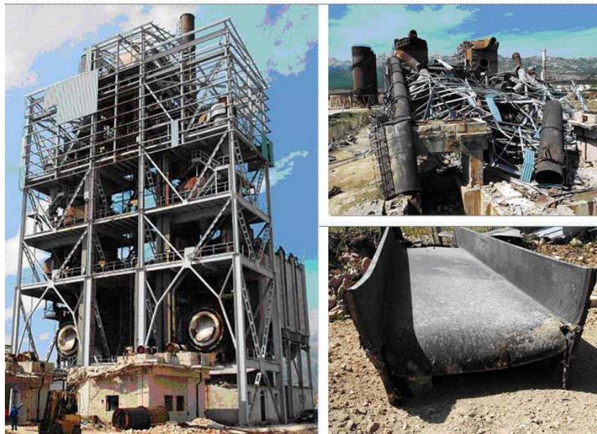
Slika 4-10. Objekt prije rušenja, nakon rušenja i presječeni dio konstrukcije (Sućeska et al. 2005).
