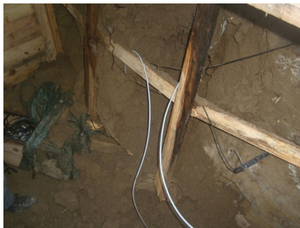
Slika 5.15. Urušeni pedološki profil s monitoring opremom.
