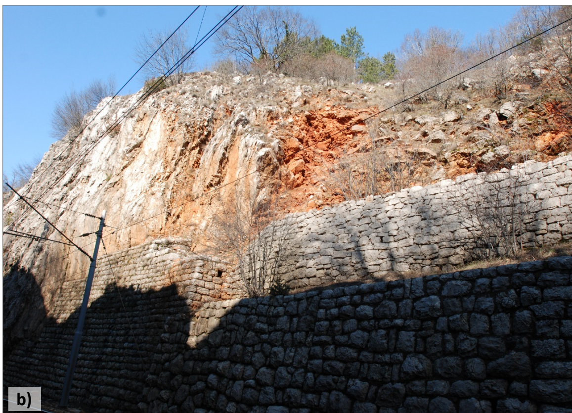
Slika 6-19. IG prospekcija kosine 202-61-D: a) razlomljena zona s izraženom pojavom okršavanja; b) široka rasjedna zona sanirana potpornim zidom
