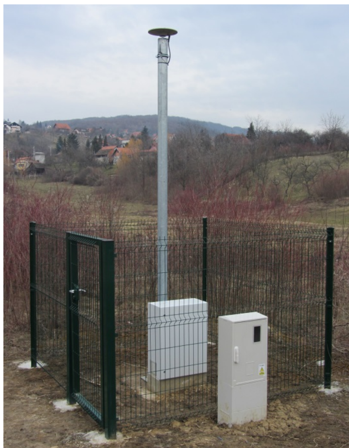
Slika 4.2. Jedna od 15 permanentnih GNSS stanica „Opservatorija za praćenja klizišta Kostanjek“. GNSS antena je smještena na pocinčanom stupu visokom četiri metra, temeljenog s arminirano-betonskim temeljem dubine jedan metar. GNSS prijemnik, uređaji za bežični prijenos podataka i uređaji za napajanje električno energijom smješteni su u ormarićima.
