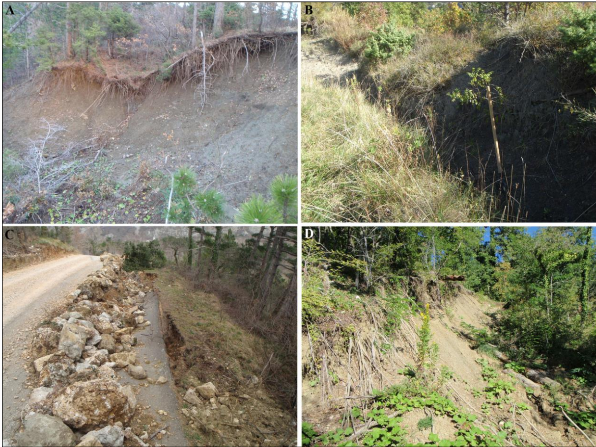
Slika 6-9. Primjeri manifestacija klizanja na terenu (A – ID 28; B – ID 37; C – ID 38; D – ID 34). Na slikama A, C i D su prikazane černe pukotine klizišta, a na slici B je prikazana bočna pukotina klizišta.
