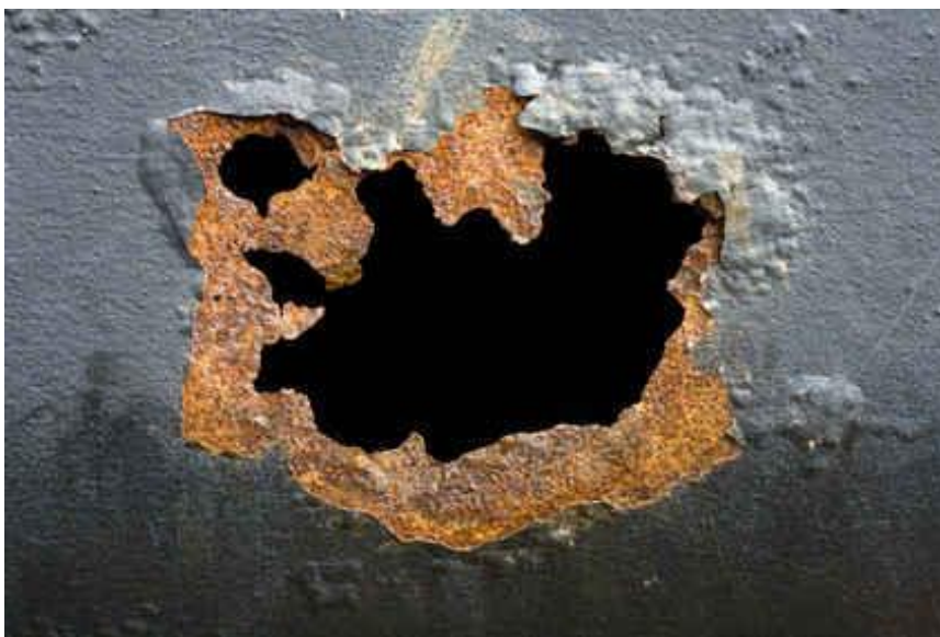
Slika 4-3. Jamičasta korozija (Pursanova, 2016)
