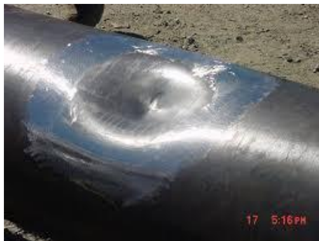
Slika 3-2. Obično udubljenje naftovoda (Spalink, 2018)
