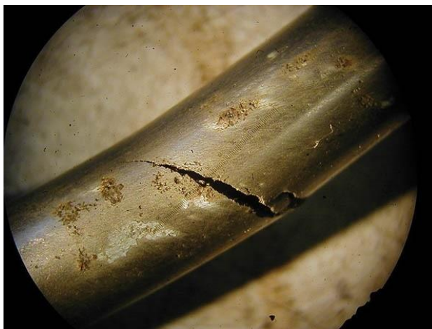
Slika 2-2. Primjer pukotinske korozije (Sachs, N. 2018, Efficient Plant, Corrosion: Undertand It to Fight It)
