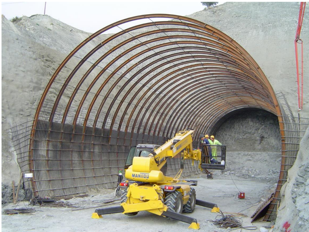
Slika 5-4. Detalj čeličnog luka pri bušenju ulaznog portala tunela (TEDESA - Técnicas de Entibación, S.A., 2013.)
