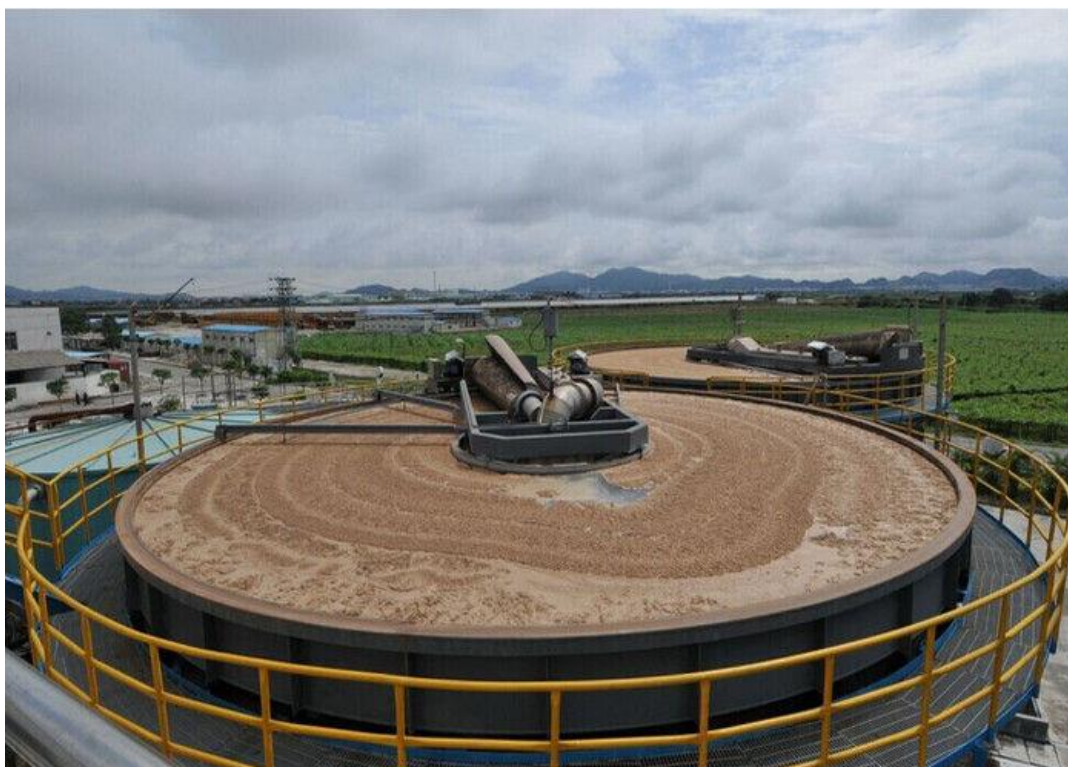
Slika 2-6 Flotacija (Seawater ro plant, 2018)
