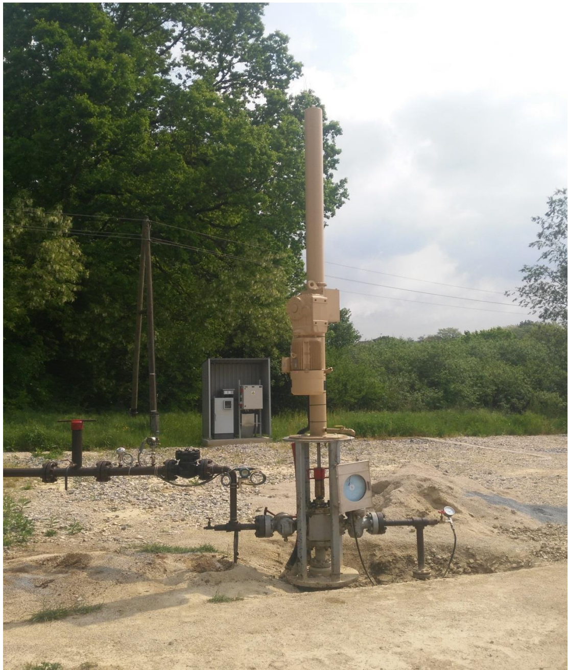
Slika 5-1. Prikaz površinskog dijela opreme bušotine X-1 nakon ugradnje LRP uređaja
