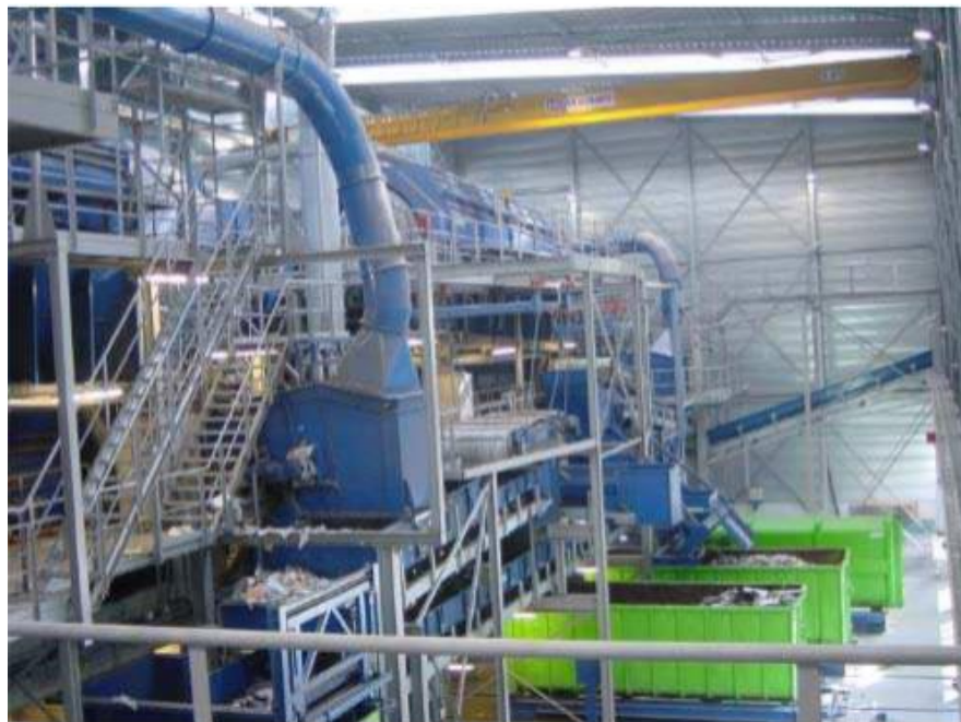
Slika 4-10: Dio postrojenja za mehaničku obradu otpada (Bekavac, 2010.)
