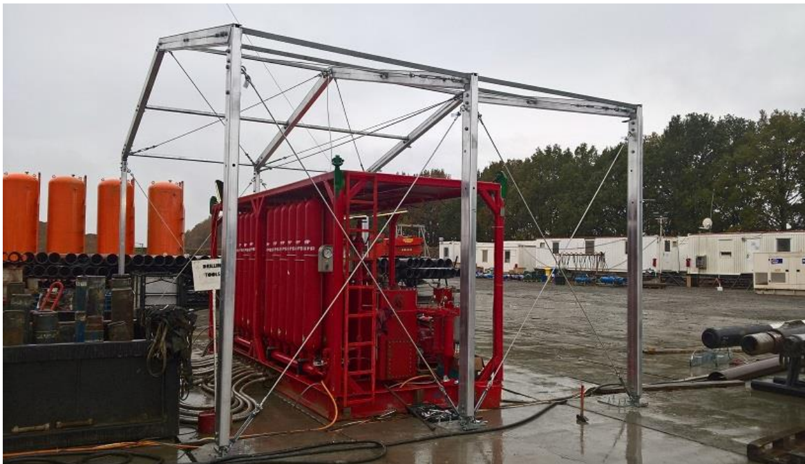
Slika 3-2. Konstrukcija šatora 6 (akumulatorska jedinica) (Crosco, 2017b)
