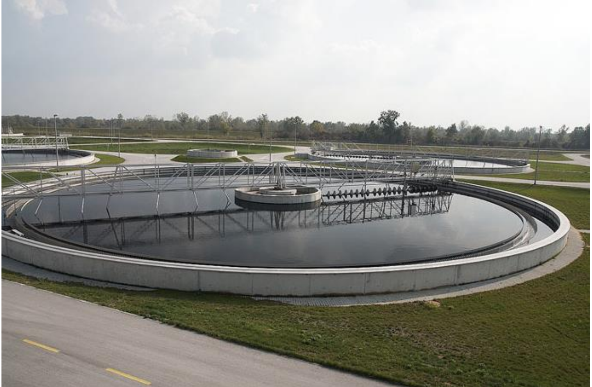
Slika 4-8. Kružni taložnik na uređaju za pročišćavanje u Zagrebu (Zov Zagreb 2009)
